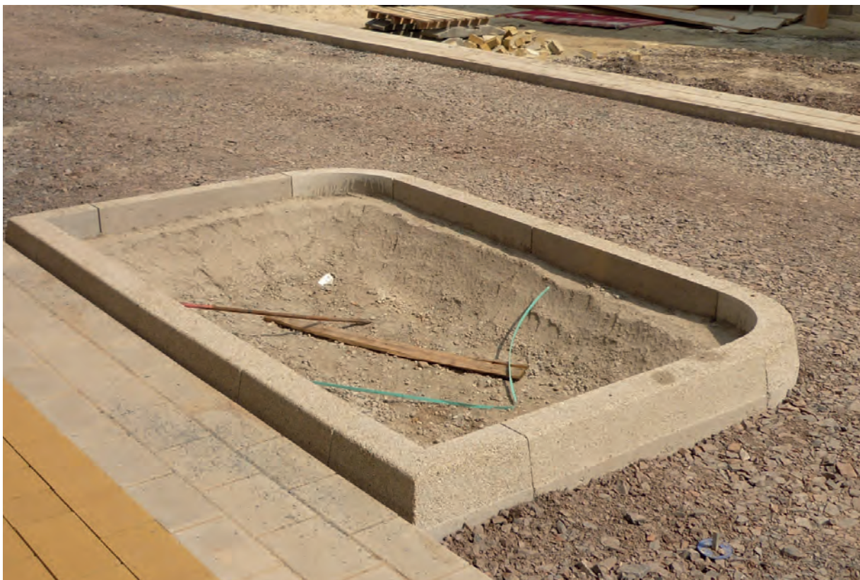
Abbildung 14: Erfolgt die Planung und Errichtung von Baumstandorten allein mit Rücksicht auf die Belange des Straßen-, Tief- und Kanalbaus, so wie in diesem Beispiel zu sehen, haben Bäume keine Zukunft, und die Sinnhaftigkeit von Gehölzpflanzungen, die zumeist mit hohen Erwartungen an den Baum einhergeht, ist dort zwingend zu hinterfragen.
