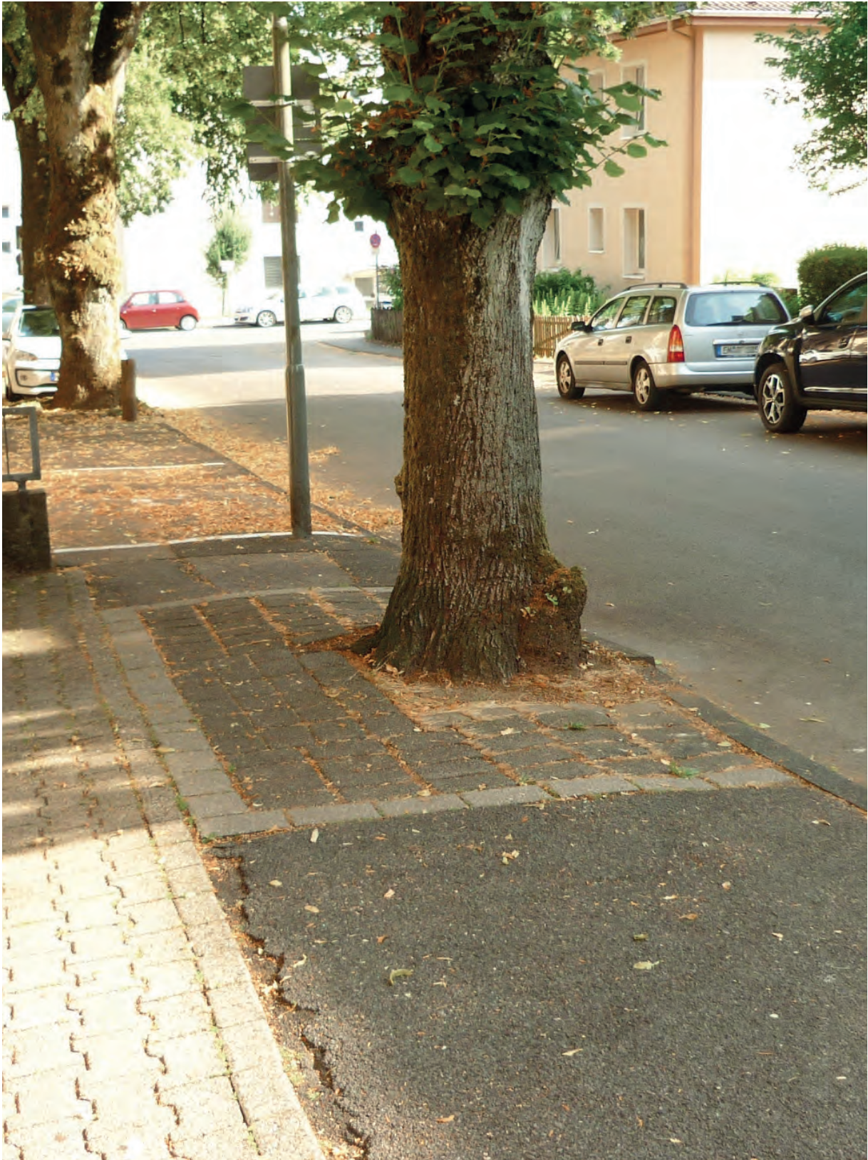
Abbildung 9: Dieser Baumstandort in der Tobienstraße spiegelt das Spannungsfeld wider, in dem Baumpflanzungen oft noch immer realisiert werden müssen. Die zu beklagenden Schäden durch das Wurzelwachstum sind hier eine Folge der mit der Standortgestaltung einhergehenden Bodenbearbeitung.
