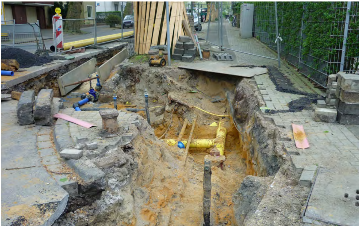
Abbildung 11: Bäume konkurrieren im Straßenbereich insbesondere unter der Erde mit der technischen Infrastruktur um denselben Raum, der knapp bemessen ist und von verschiedenen Parteien beansprucht wird. In aller Regel, so wie in diesem Beispiel zu sehen, wird diese Situation zu Lasten der Bäume mit zum Teil schwerwiegenden Folgen „gelöst“.
